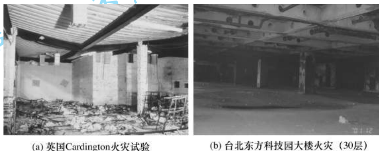
图 16 火灾下压型钢板组合楼板的大挠度变形
